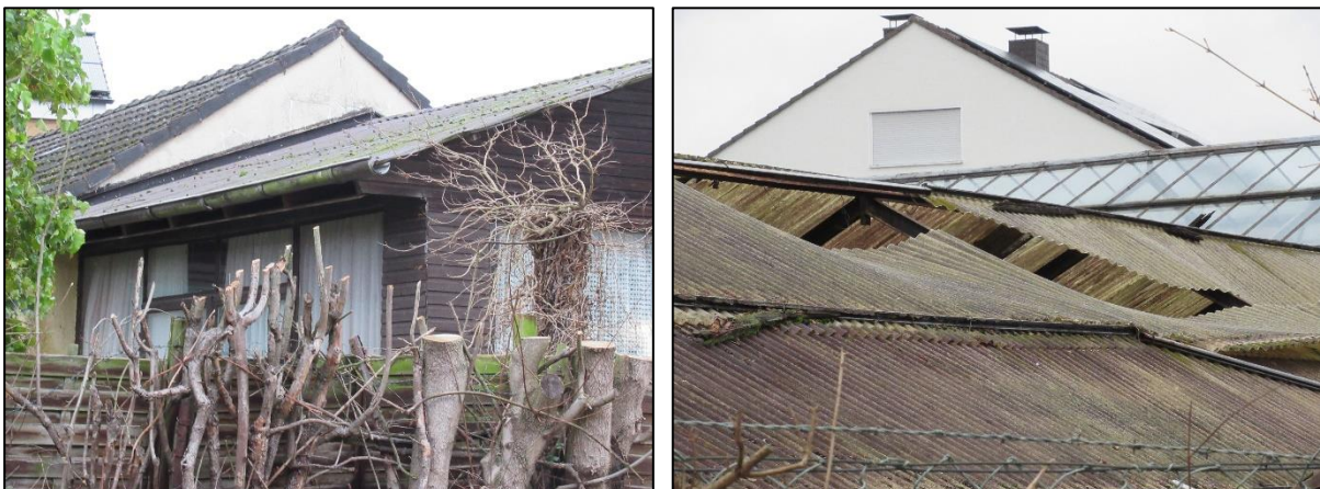
Abbildung 11: Schadstellen und Einflugmöglichkeiten an den Gärtnereigebäuden
