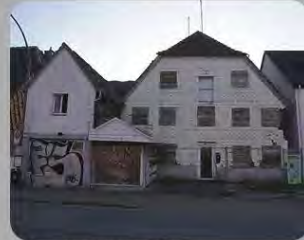
Sanierungsbedürftige Gebäude in der Rasthofstraße
